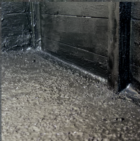
Auch dicht in den Ecken
